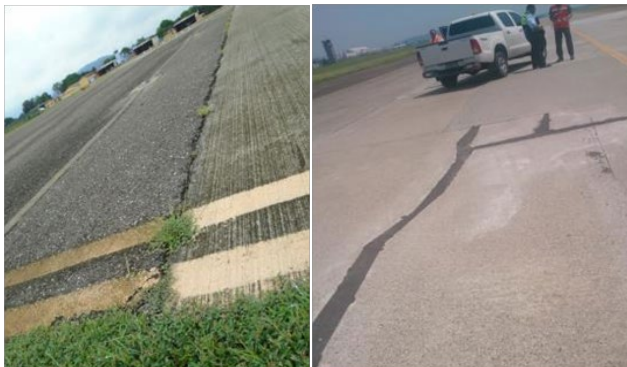
Figura 8. Presencia de fisuras en calle de rodaje (izq), pista en proceso de reparación (der) Fuente: Foto tomada por equipo de investigación.
